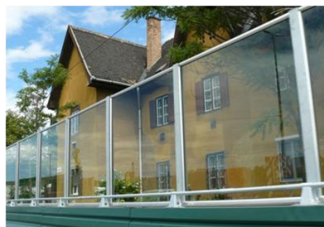
Alumínium keretbe foglalt biztonsági üvegből készült zajvédő fal a Nagykőrösi úton
